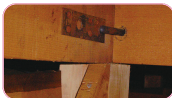
小屋裏から筋交いの取付け状況や羽子板ボルトの有無を調査
