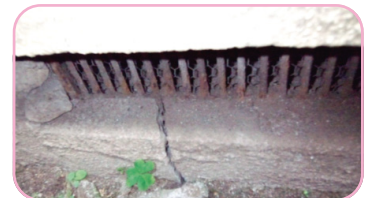
基礎のひび割れを調査
