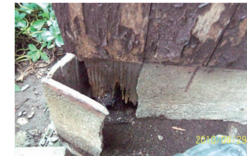
柱脚の腐朽を調査
