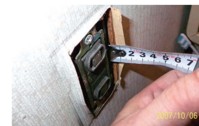
仕上げを壊さずにコンセントカバーを外して、下地材の厚みを調査
