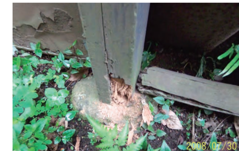
柱脚の腐朽を調査
