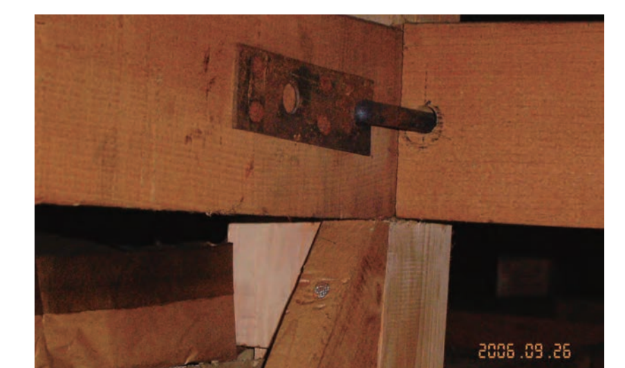
小屋裏から筋かいの取り付け状況や羽子板ボルトの有無を調査
